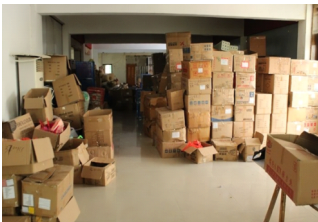
住宅改作仓库、楼面超载
