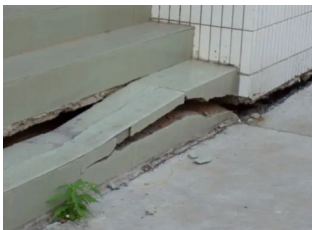
地基基础下陷引起室外地坪开裂
