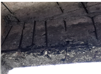
梁钢筋锈蚀、保护层脱落
