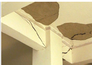
梁构件端部斜向裂缝
