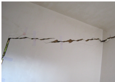
承重砖墙贯穿开裂
