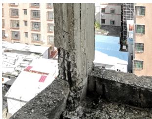
柱钢筋锈蚀、保护层脱落
