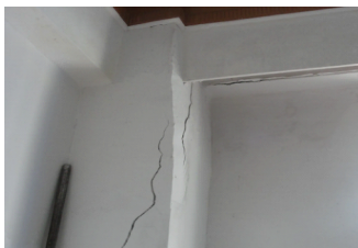
柱构件纵向顺筋裂缝， 可能为钢筋锈胀引起
