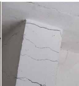
柱构件水平裂缝
