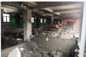
私自开挖地下室
