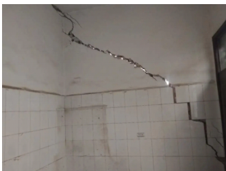
地基不均匀沉降引起墙体斜向开裂
