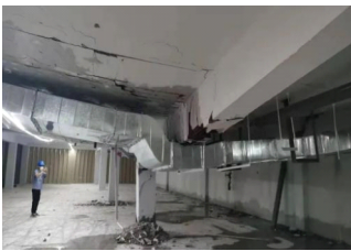
混凝土梁下挠
