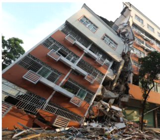
建筑下方跨(暗)渠建设 (可能腐蚀桩基础)
