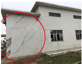
沉降不均匀引起房屋开裂
