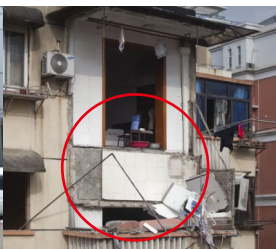
悬挑阳台坍塌
