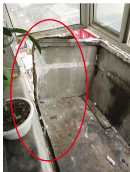
悬挑阳台开裂、大变形
